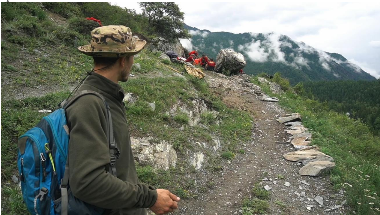
Фото 21. Выравнивание крена и расширение тропы. Использование плоских камней для снижения угла крена.
