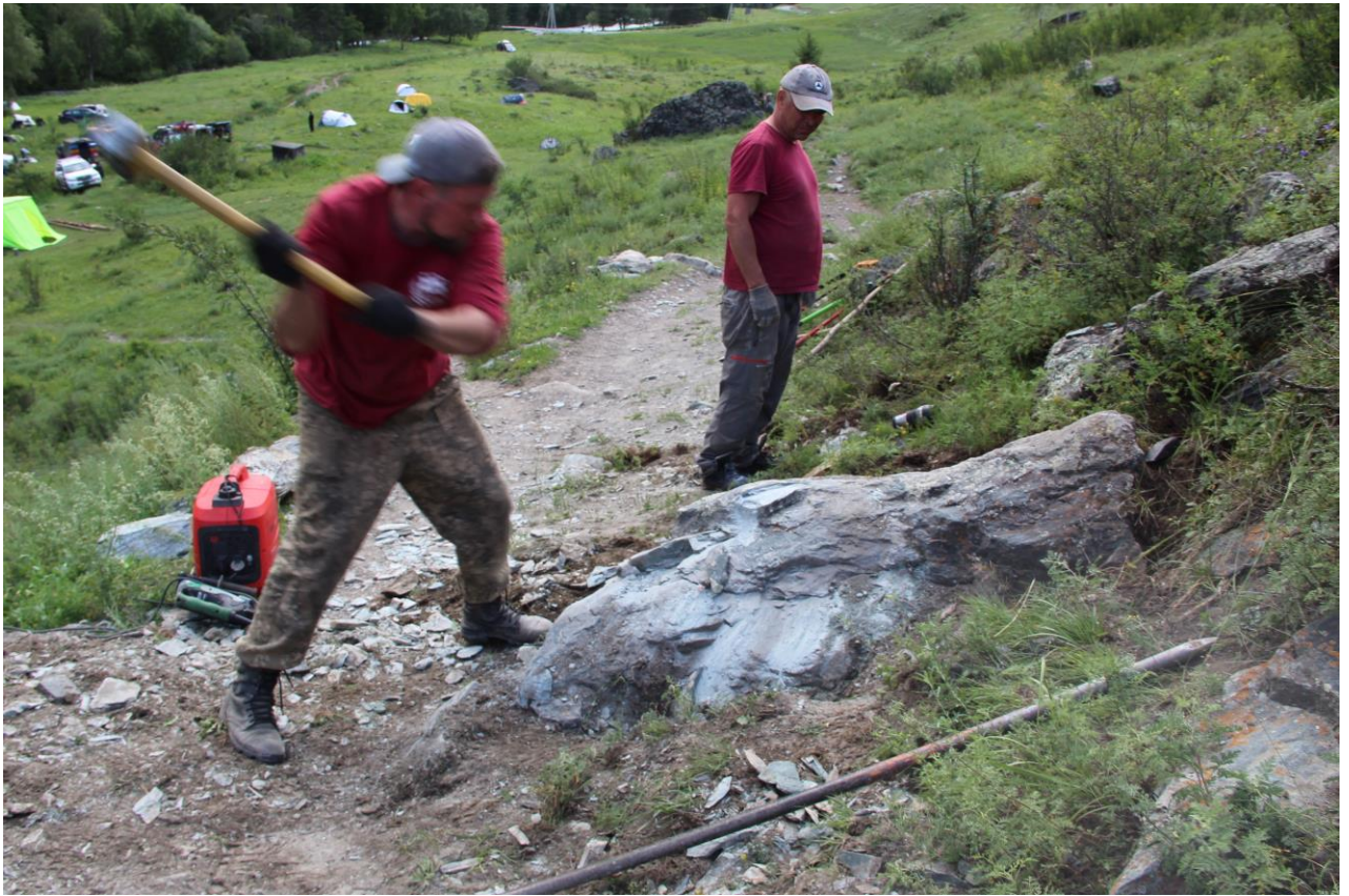
Фото 33. Удаление большого лежащего камня с тропы. После того, как камень треснул от действия камнекольных клиньев кувалдой добиваем по трещине.
